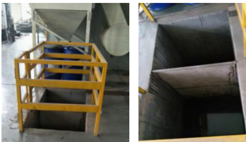
循环防渗水池
