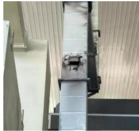
收砂工序采样口
