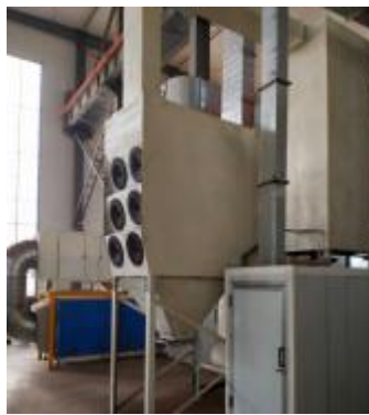
收砂工序滤筒除尘器
