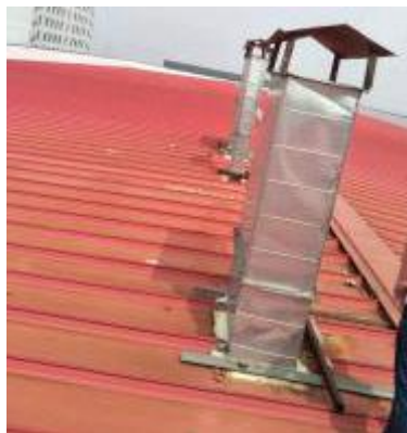
喷漆室及烘干室 15m 高排气筒
