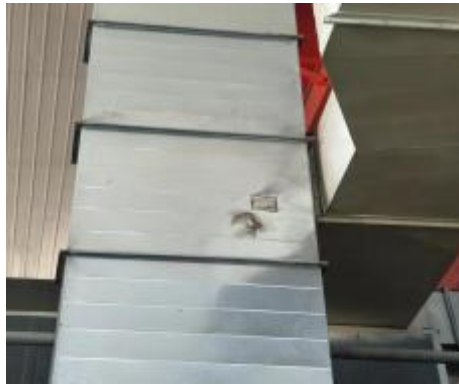
喷砂室采样口
