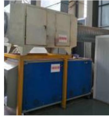
喷漆室及烘干室活性炭吸附+光催化氧化装置
